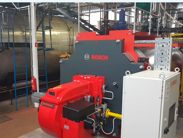
Novi vročevodni kotel
