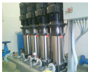
Slika 2: Postrojenje črpalk v prečrpališču Paričjak
