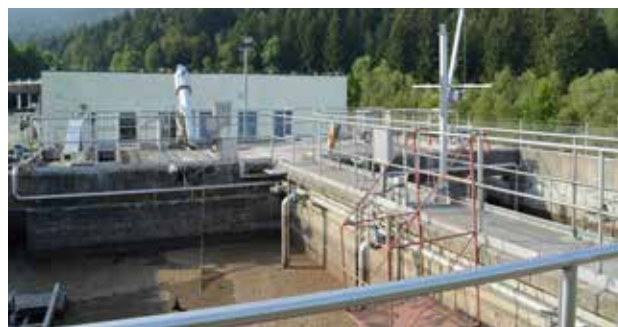
Čistilna naprava Mislinja
