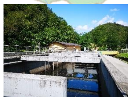
Centralna čistilna naprava
