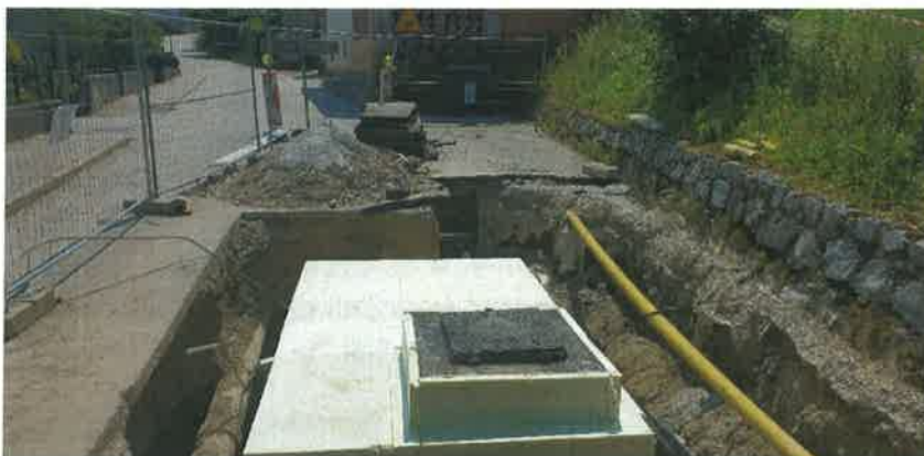
Vodovodni jašek s hidravličnim zadrževalnim ventilom
