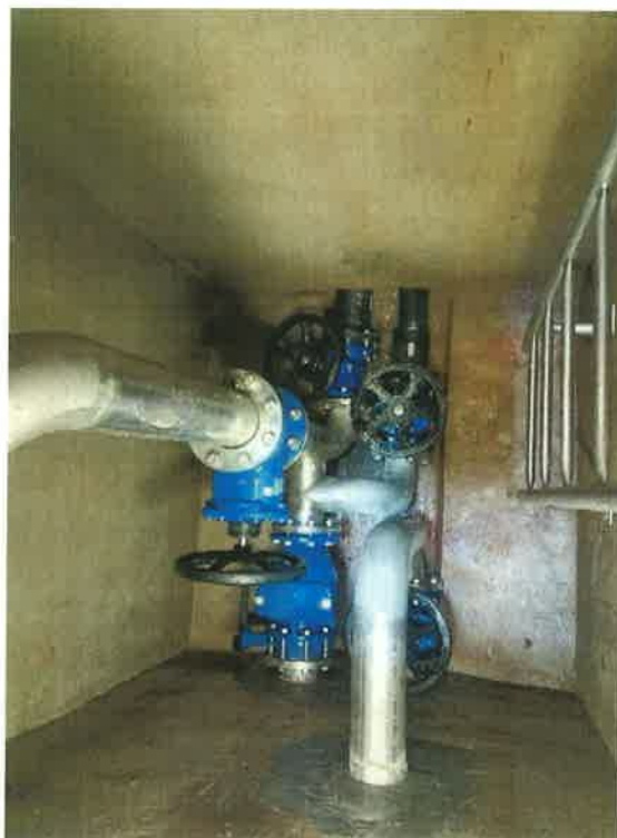
Obnovljena strojna oprema v VH Plešivca
