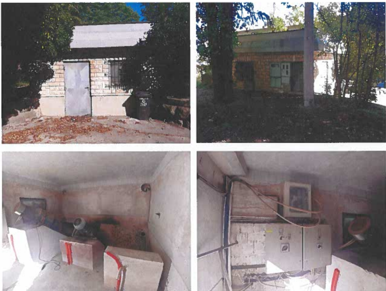
Slika 3: Fotografije črpaljšča pri skladišču Grando
