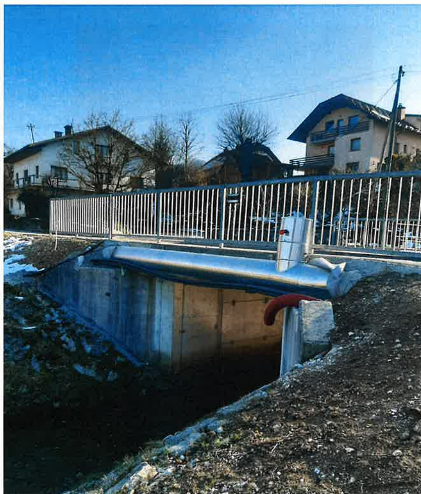
Konzolno obešen primarni vodovod z izolacijo
