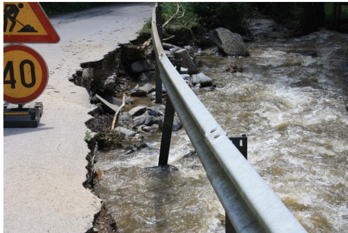
Slika 11: Poškodbe na lokalni cesti v Skomarju povzročene 18. 7. 2021
