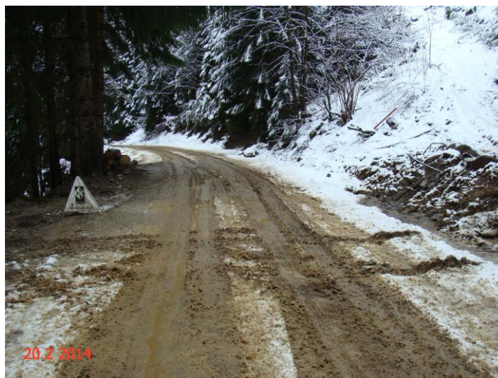
Slika 3: Poškodbe cestišča ob spravilu lesa.
