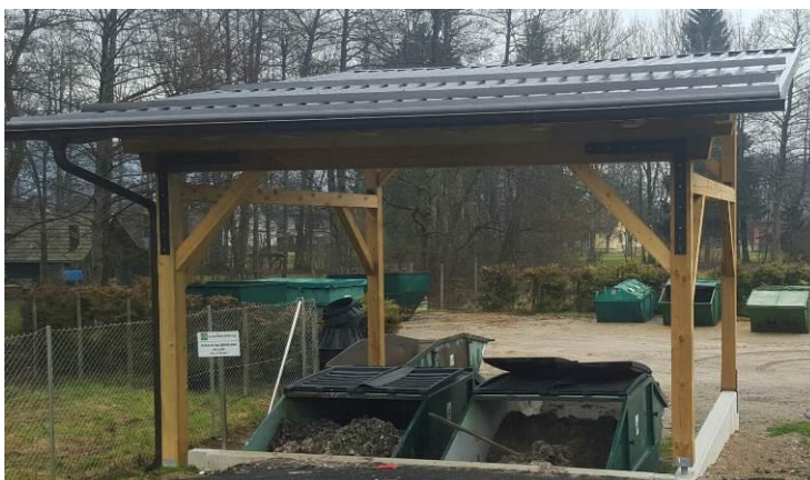
Slika 8: Zabojniki za začasno skladiščenje odpadkov iz grabelj, sit in peskolova
