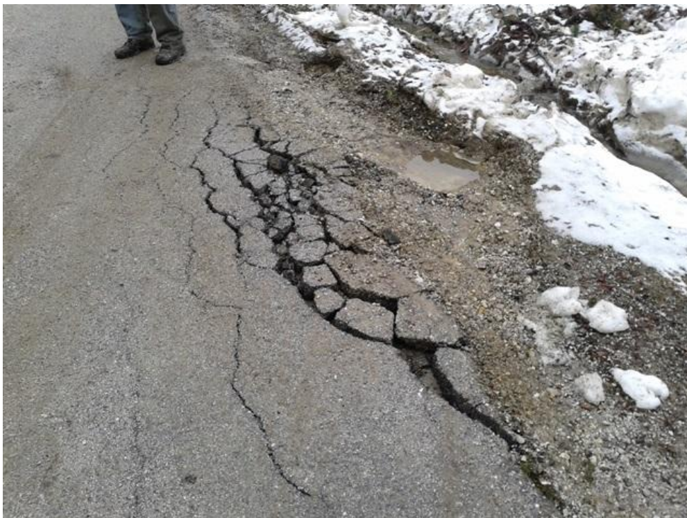
Poškodba cestišča ob spravilu lesa
