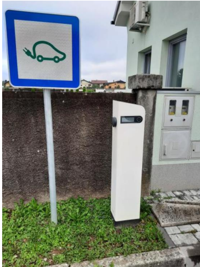
Slika 39: Polnilna postaja Etrel za električna vozila na parkirišču pri pokopališču Šenčur Vir: Gorenjske elektrarne
