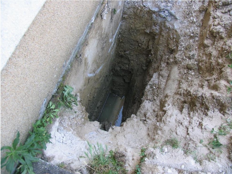
Nenačrtovano globoko temeljenje.
