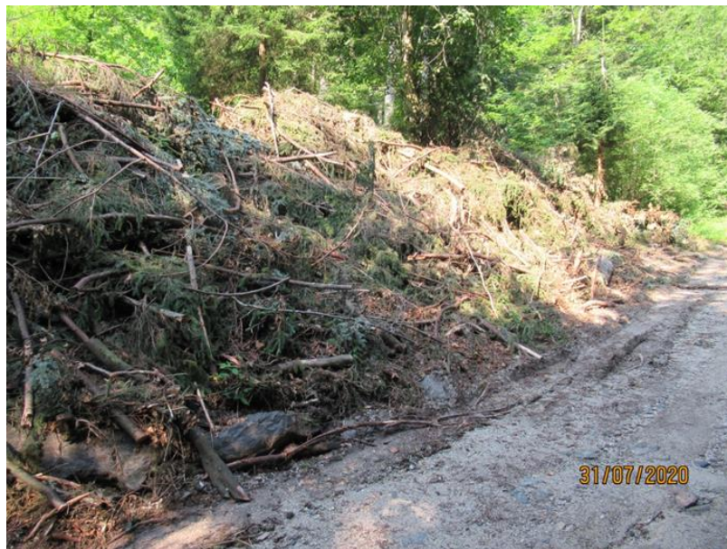
Slika 1: Ostanke sečnje v cestnem svetu, poškodbe cestišča
