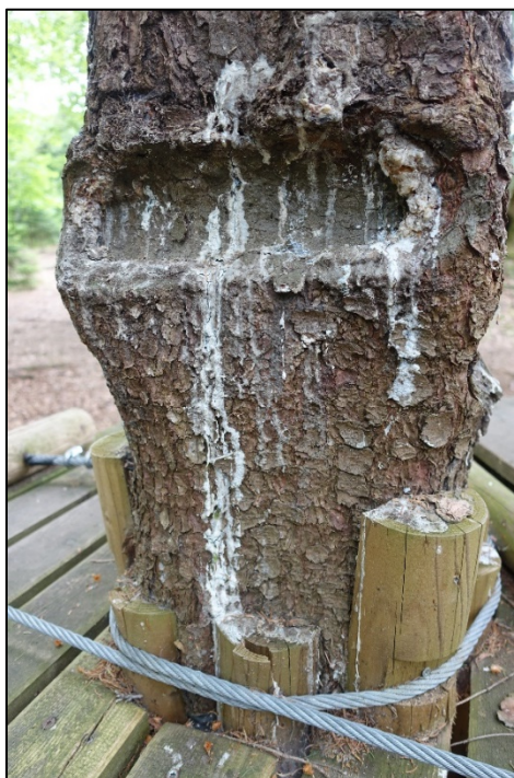
Slika 22: Močno smoljenje zaradi starih poškodb iz leta 2009 (foto R. Brus)
