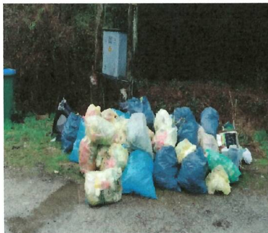
Nedovoljeno odlaganje odpadkov pri trafo postaji
