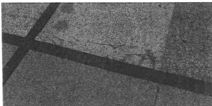
Slika: Vidne poškodbe in pretekla popravila tlaka ploščadi vnašajo vrsto novih vzorcev in površinskih obdelav
