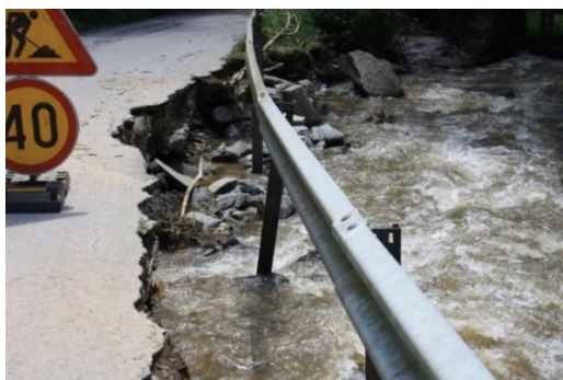
Slika 92: Poškodbe na lokalni cesti v Skomarju povzročene 18. 7. 2021
