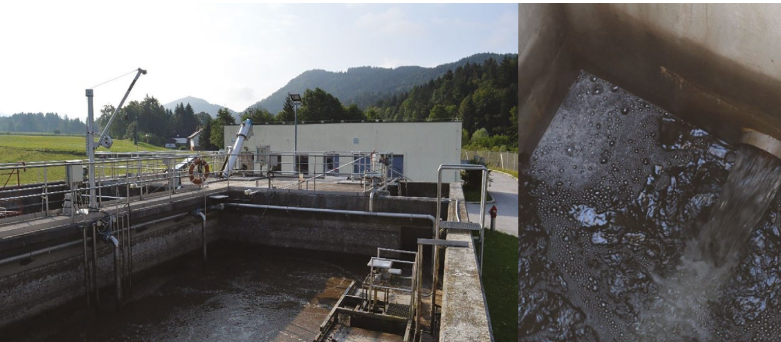
Čistilna naprava Mislinja (levo); izpust iz naprave (desno)
