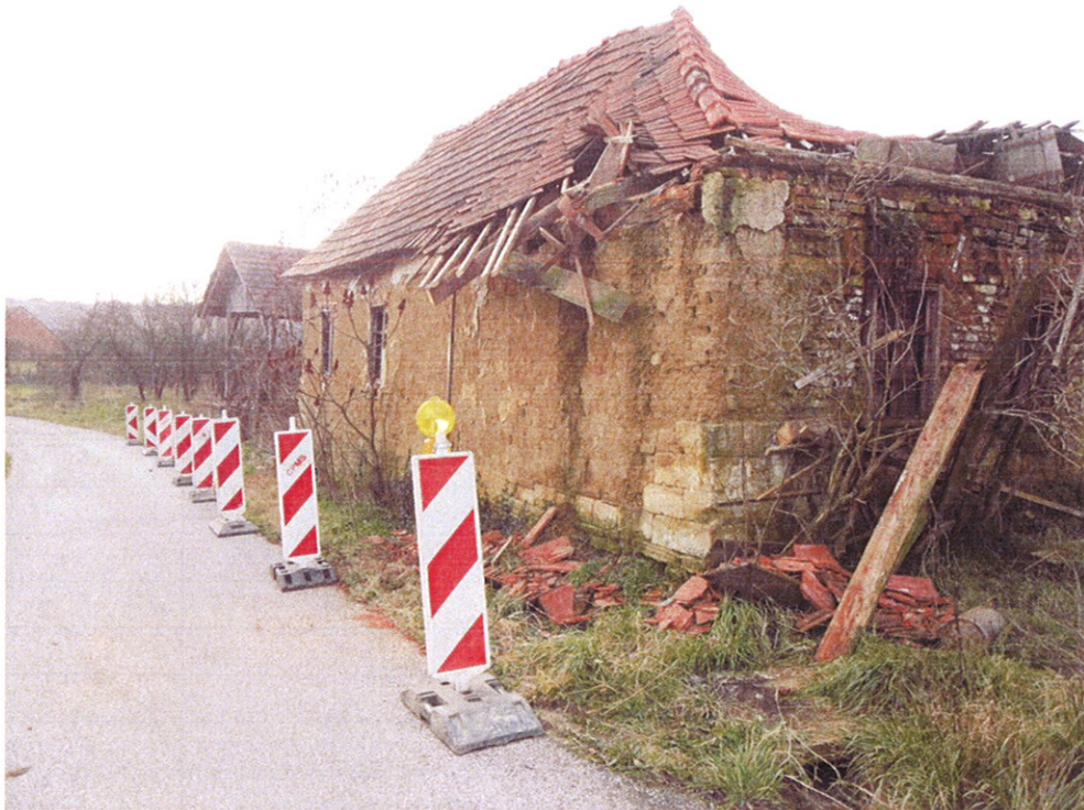
Ivanjski vrh: prometna signalizacija ob porušenem objektu, ki ogroža občinsko cesto
