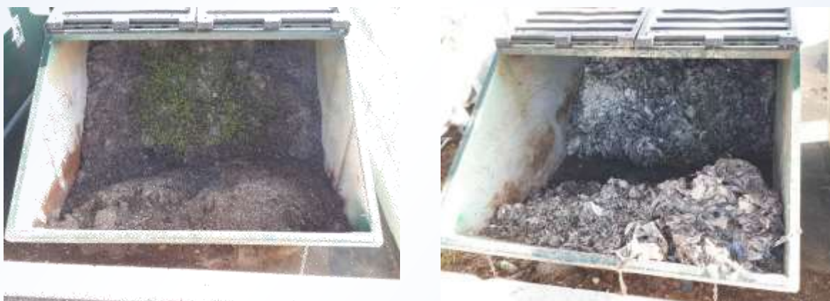
Slika 18: Zabojniki za začasno skladiščenje odpadkov iz grabelj, sit in peskolova
