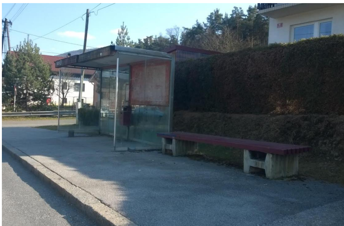
Slika 2: Primer nadstrešnice dotrajanega videza 2
