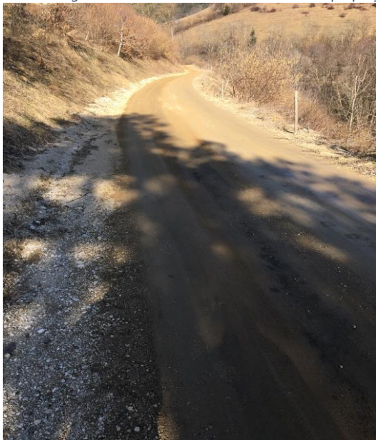
Slika 1: Pogled na traso lokalne ceste LC 350 381 pri profilu P1, (pri odcepu za kmetijo Črešnik)
