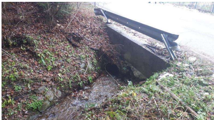
Slika 1: Poškodovanje jeklene varnostne ograje na premostitvi potoka iznad Šentanela–pritok 5
