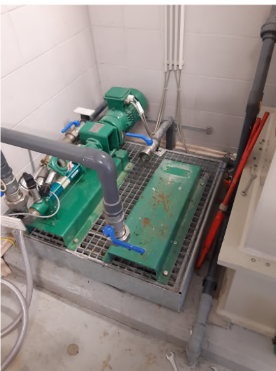
Okvara črpalke za polymer
