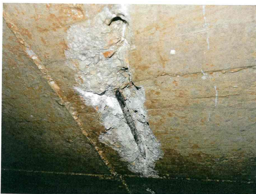
18. Sonda v stropu. Zaradi korozije je lokalno prekinjen celotni nosilni presek armature
