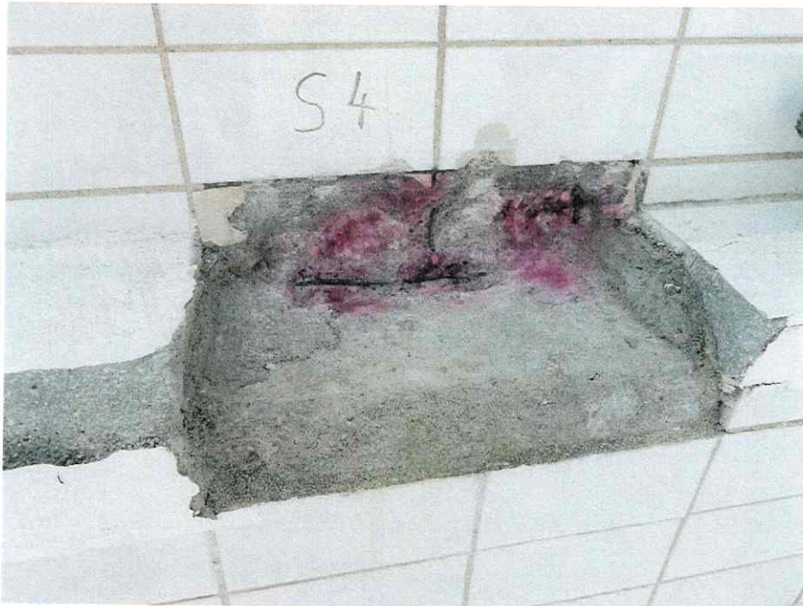
11. Sonda št. 4 na delno armirani južni steni z močno korodirano armaturo GA fi 6mm
