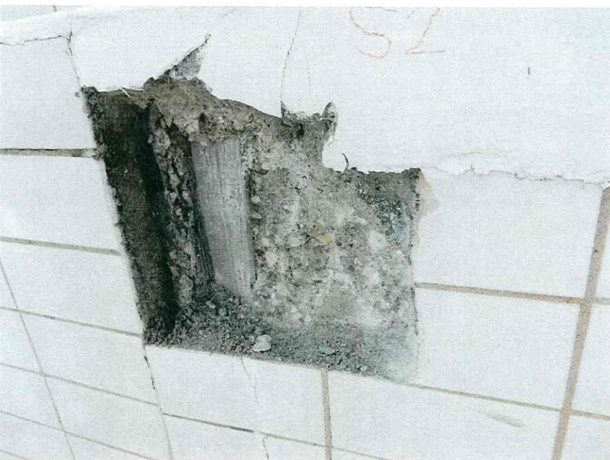
9. Sonda št. 2 v območju južne sicer delno armirane stene z neustrezno vgrajenim dilatacijskim trakom
