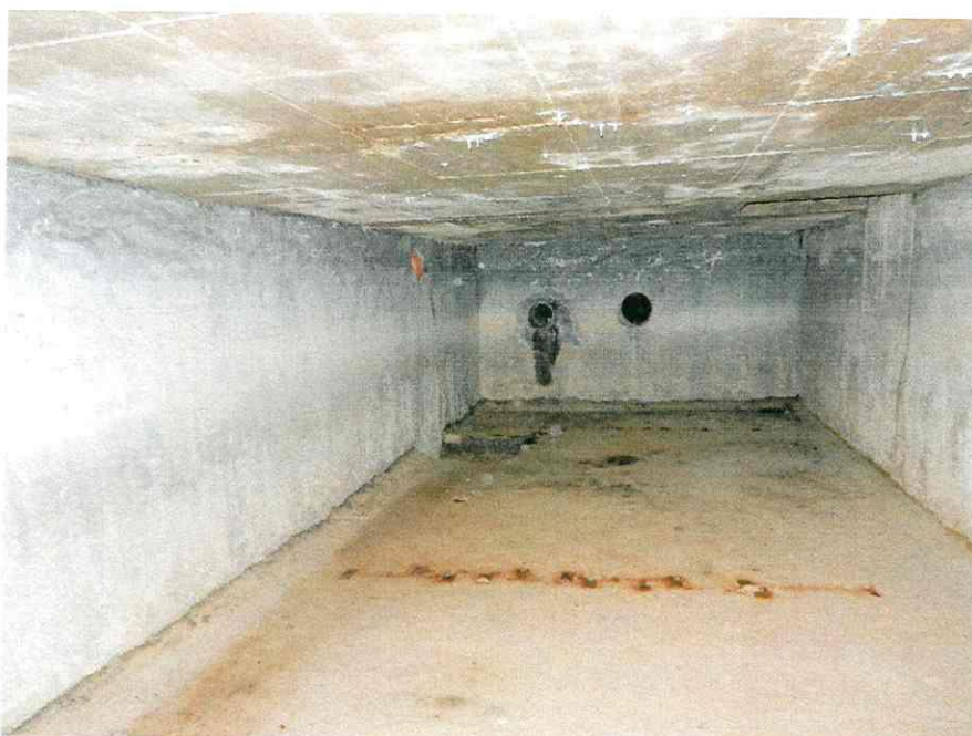
15. Severni del z vidnimi razpokami na stropu, nevodetesnem betonom in slabo tesnjenimi cevmi strojne napeljave
