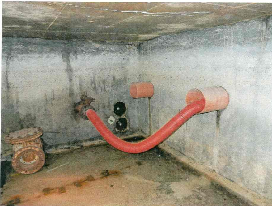
14. Južni vstopni del z vidnimi razpokami na stropu, nevodetesnem betonom in slabo tesnjenimi cevmi strojne napeljave
