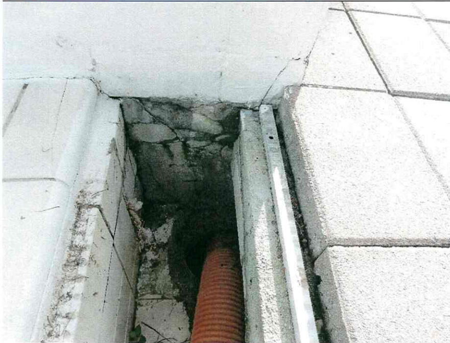
7. Tipične poškodbe v območju pretokov
