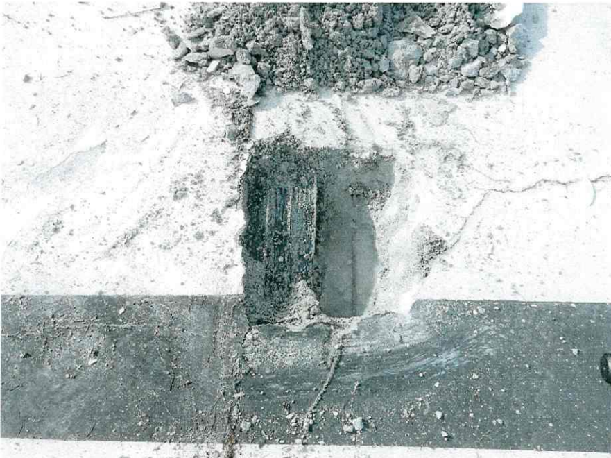
8. Sonda št. 1. v »zgornji« pomanjkljivo armirani talni plošči MB15MPa z neustrezno vgrajenim dilatacijskim trakom in neustrezno vgrajeno armaturo
