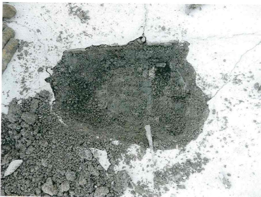
12. Sonda št. 5 na dnu kjer se v popolnoma degradirani zgornji nearmirani plošči t \approx \text{ca.} 70\text{mm} križata dva med seboj varjena tesnilna trakova, ki prekrivata dilatacije med posameznimi segmenti talne plošče
