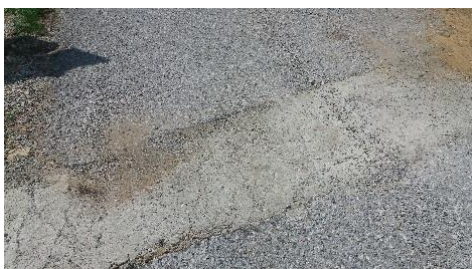
Slika 8: Nedovoljen prekop ceste
