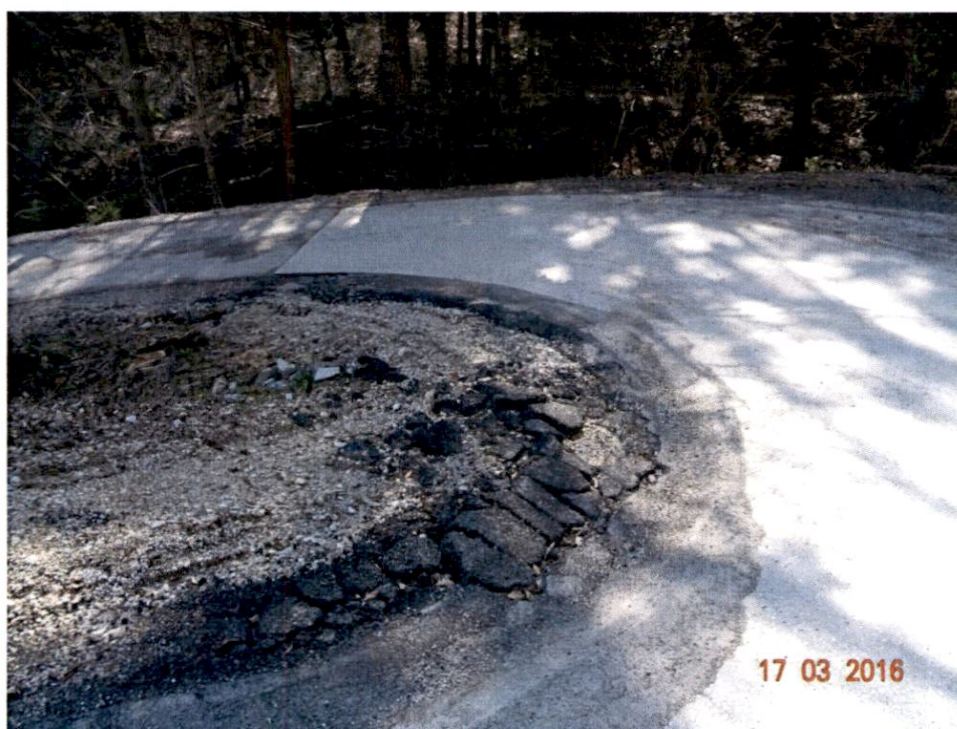
Slika 4: Poškodba občinske ceste.
