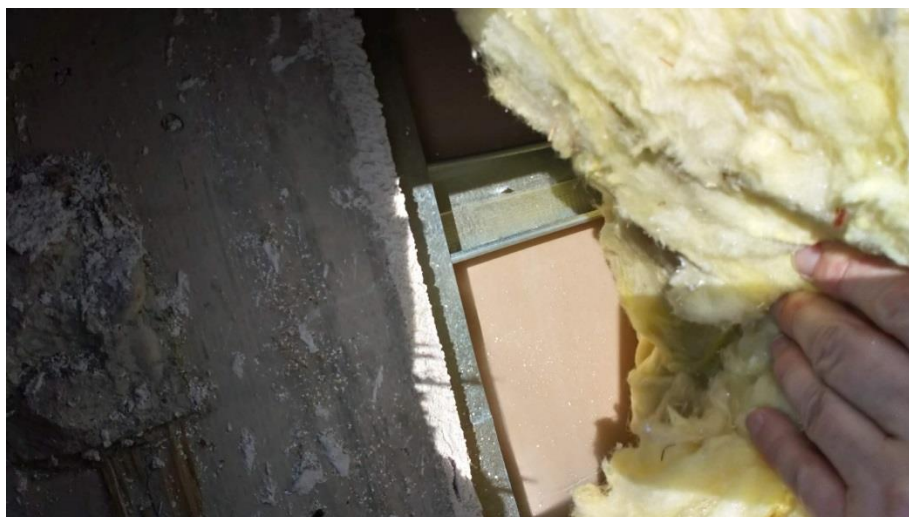
Slika 12: Neizoliran betonski nosilec, parna zapora v mansardi je slabo izvedena.
