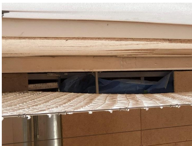
Slika 6: Nepravilna montaža parne zapore – telovadnica – slikano od spodaj navpično navzgor. Tu smo izvedli sondažo.
