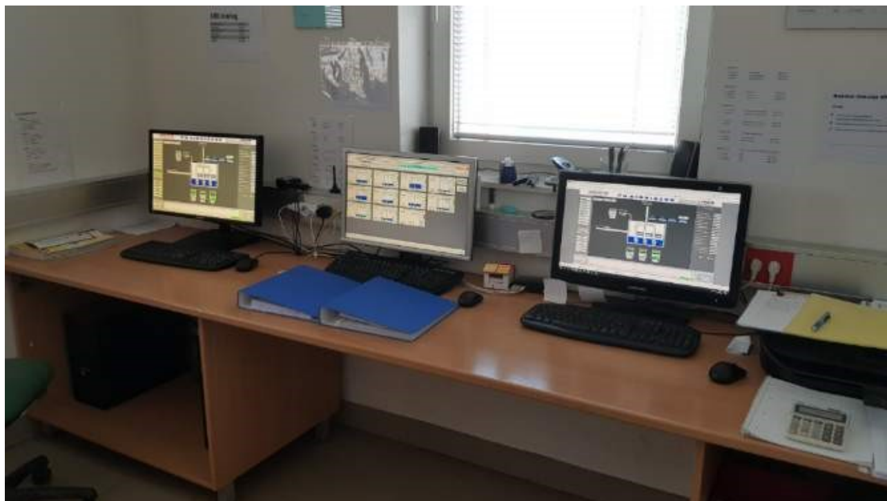
Nadzorna soba na čistilni napravi
