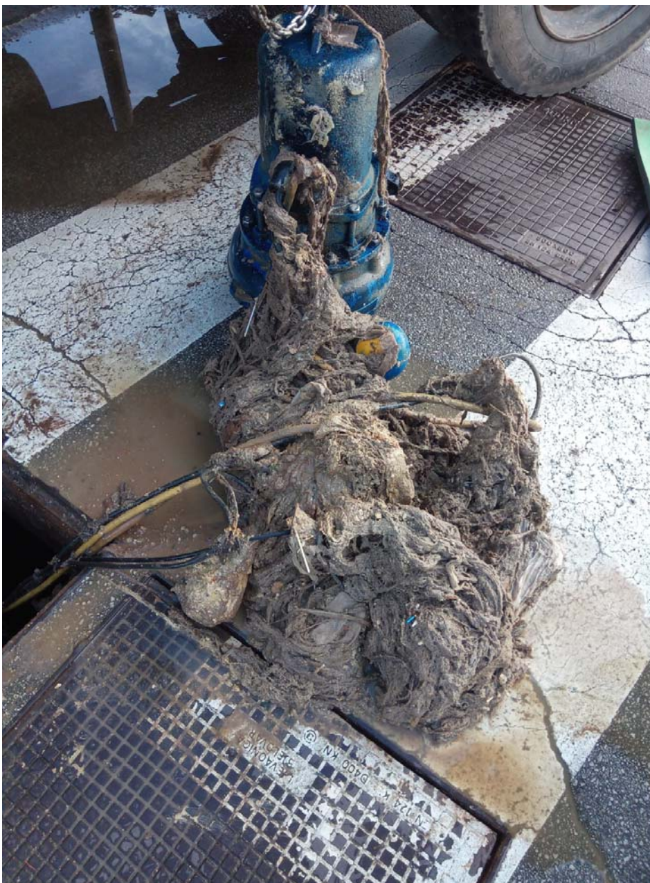
Zamašena črpalka na prečrpališču
