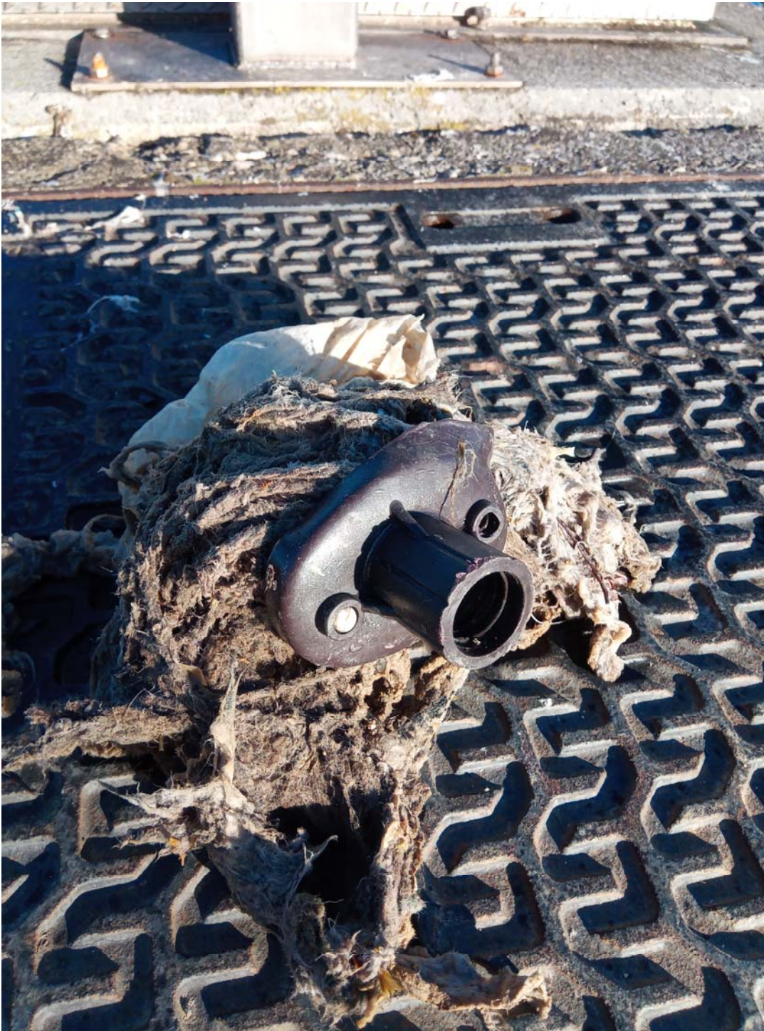
Tujki v kanalizaciji
