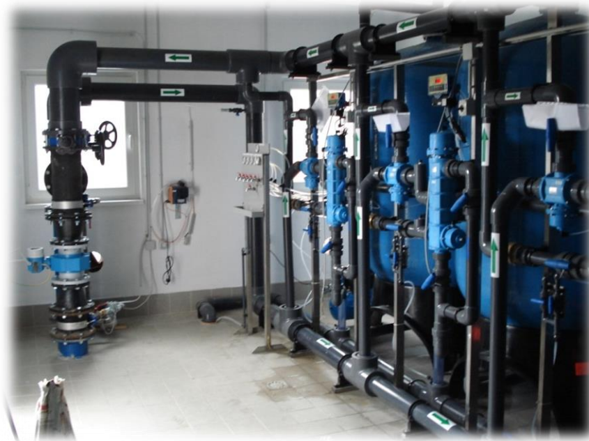
Čistilna naprava Sodražica
