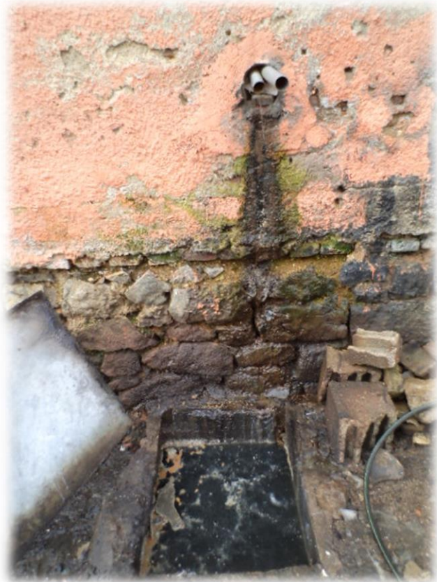
Primer malomarnega ravnanja z merilnim mestom - odtok speljan v vodomerni jašek
