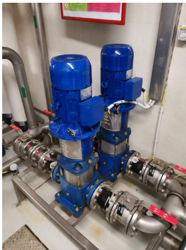
Slika 14: Črpalni blok UF pitne vode Jelovec
