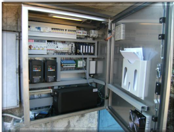
Slika 24: Krmilna omarica daljinskega vodenja in nadzora črpališče Čretvež
