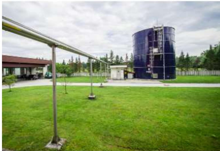
Slika 12.32: Čistilna naprava Domžale - plinohram 24 .
