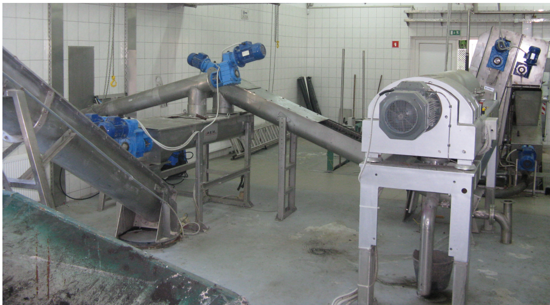
Slika št. 3: strojno zgoščevanje presežnega blata
