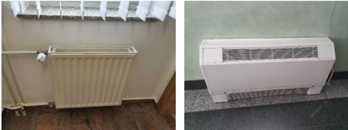
Slika 13: Radiatorji s termostatskim ventilom in konvektor v dvorani
