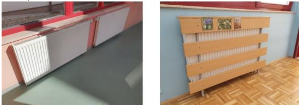
Slika 37: Radiatorji s termostatskim ventilom
