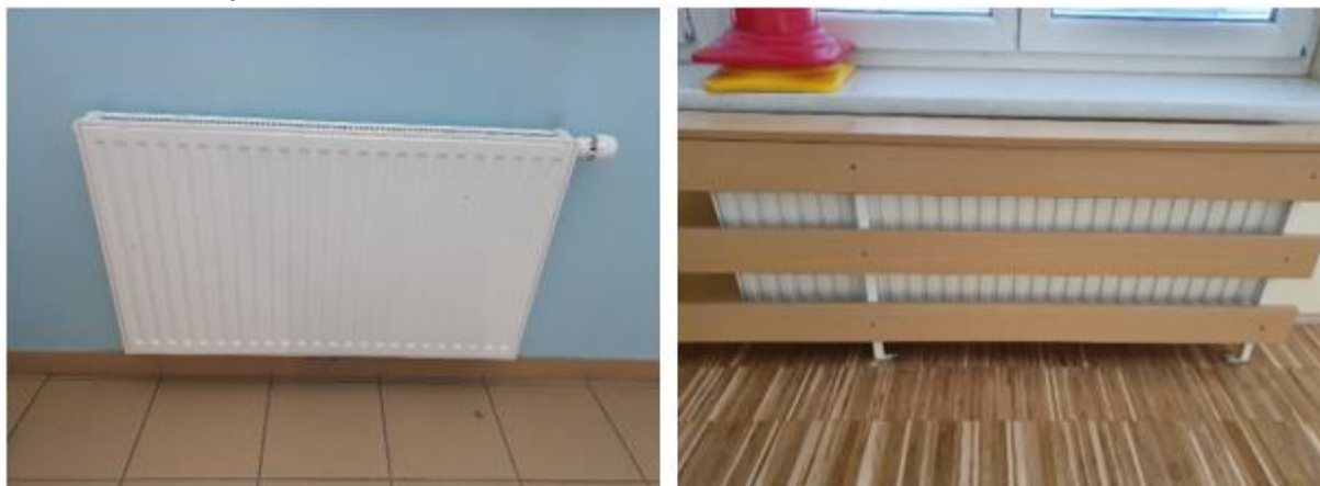
Slika 29: Radiatorji s termostatskim ventilom
