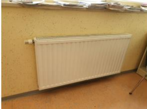
Slika 21: Radiatorji s termostatskim ventilom
