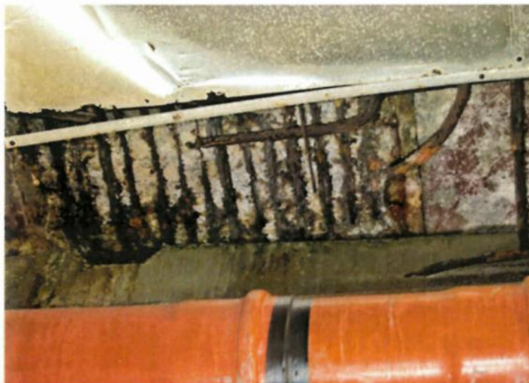
Slika št.7: Razpadanje betona in močna korozija armature plošče ob stiku z bazenom v predelu prostora s stebrom skakalnice – detajl 1 (vogalni del prostora HS in HV).
