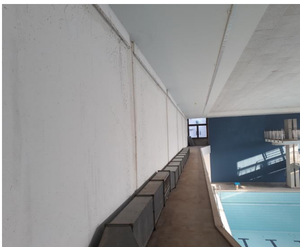
Slika 6: Prikaz kondenzacije-plesni v garderobnih prostorih
