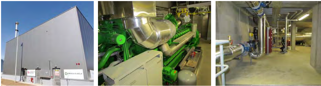
Slika 4: Objekt TOM III – kogeneracijsko postrojenje
