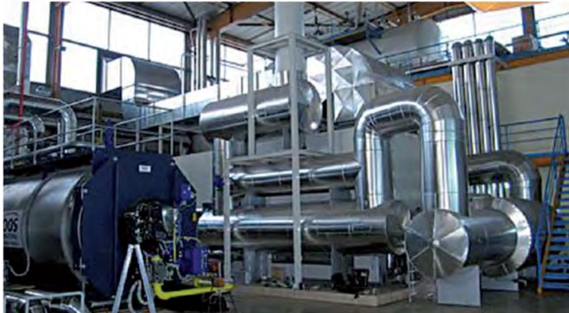
Slika 3: TOM I – kogeneracijsko postrojenje
