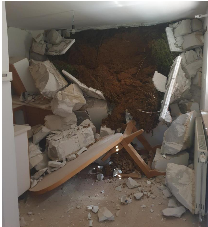
Slika 3: Plaz v stanovanjskem objektu Gornji Dolič 20A
