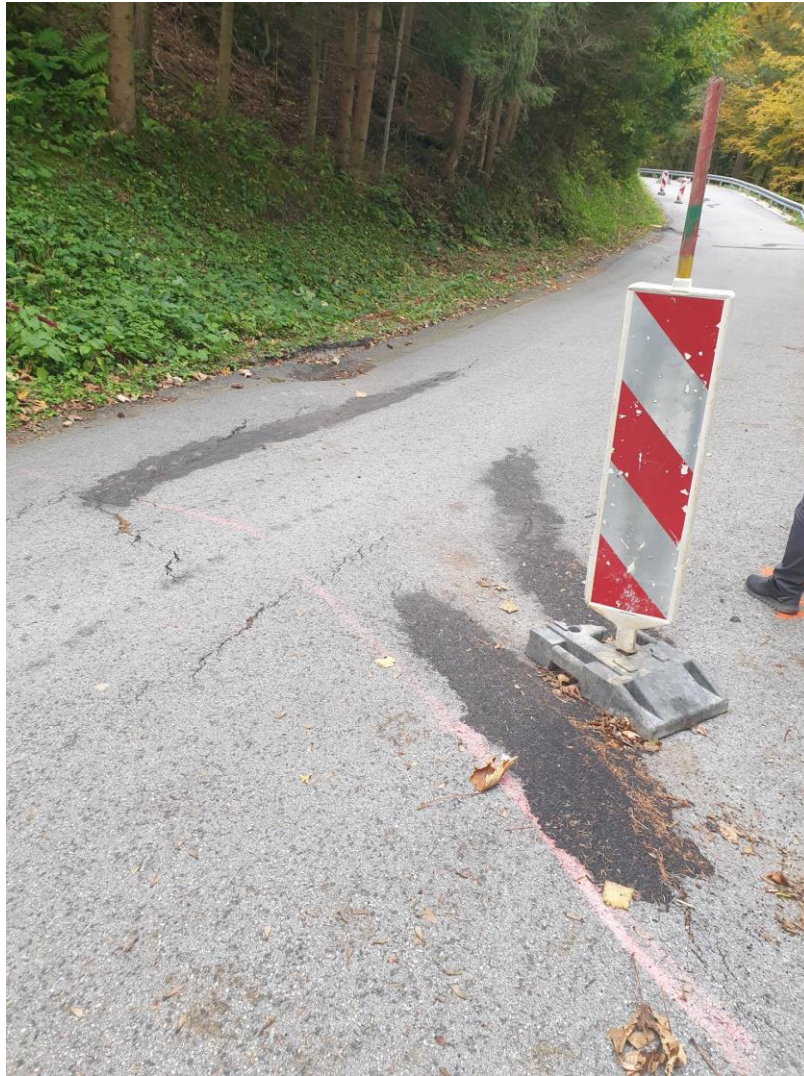
Slika 2: Plaz na lokalni cesti LC 261021, ID 1229068
