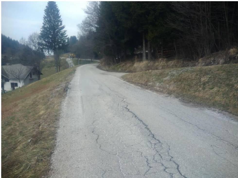
Slika 3: Stanje na območju lokalne ceste LC 261051 Mislinja - Tolsti Vrh - Srednji Dolič, ID 1229101
