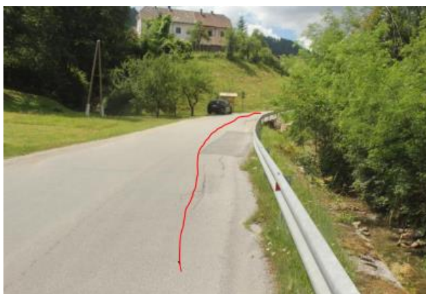
Pogled gorvodno v smeri proti Lešam, kjer se vidijo razpoke in poškodbe na cesti.
