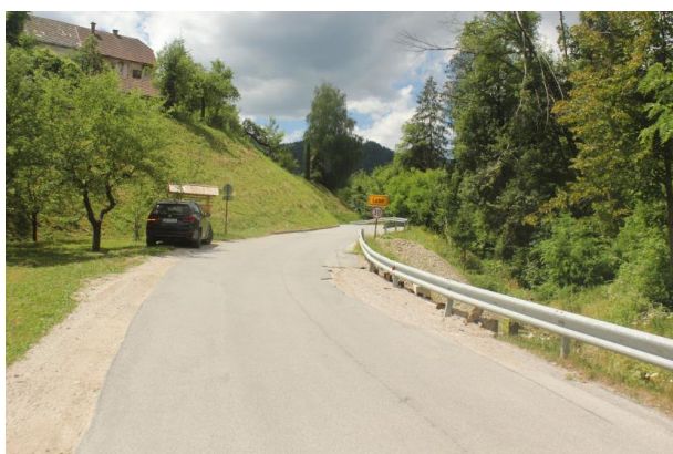
Pogled gorvodno v območje, kjer je prišlo do porušitve zidu med cesto in strugo.
