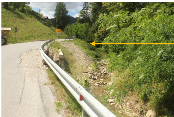
Pogled gorvodno v območju poškodbe.
