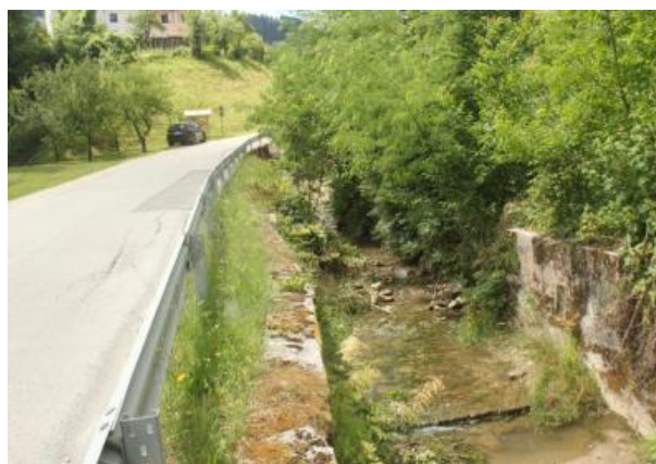
Pogled gorvodno na obstoječe betonske zidove, kjer se vidi rotiranje-nagibanja zidu med strugo in cesto, levo obalni zid zaenkrat ne kaže deformacij.
