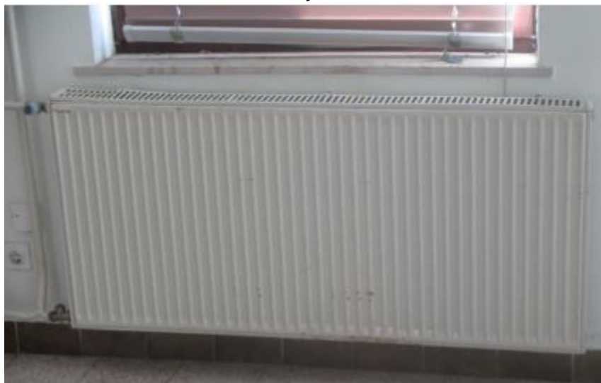
Slika 19: Radiator v dvorani z navadnim ventilom – jeklene izvedbe
