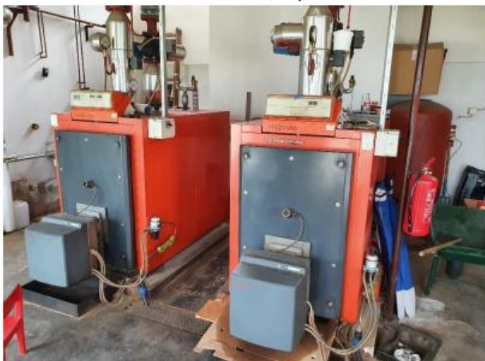
Slika 34: Kotla Viessmann PS028, toplotne moči 2x285 kW in Bojler TSV
