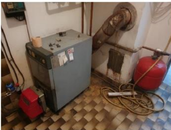
Slika 26: Kotel Ferroli moči 77 kW, razvod ogrevnih vej
