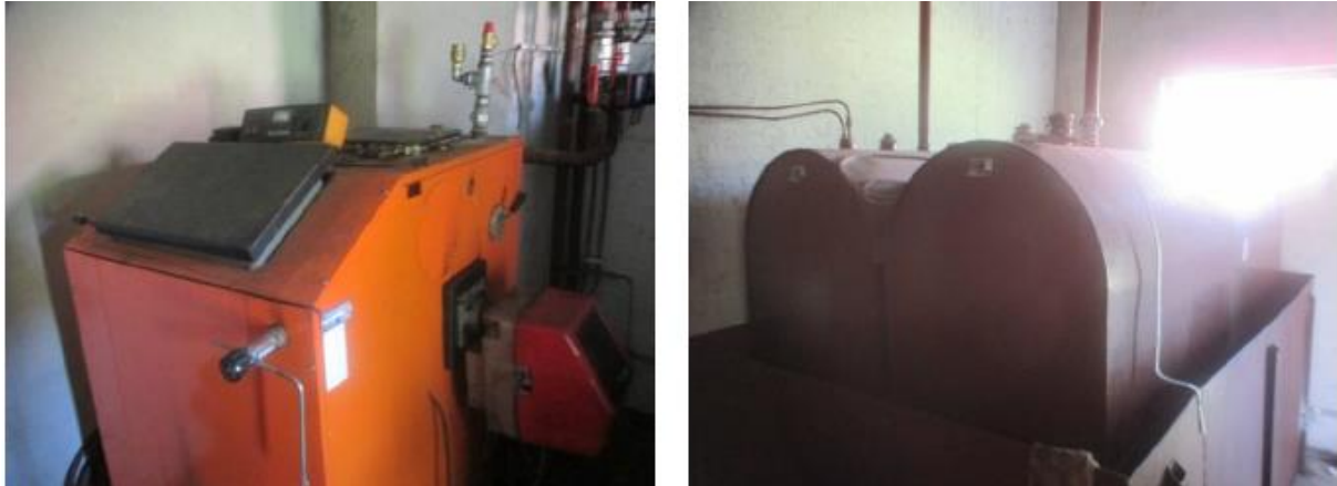
Slika 17: Kotel na ELKO moči 50 kW, cisterni za ELKO 2 x 2.170 litrov
