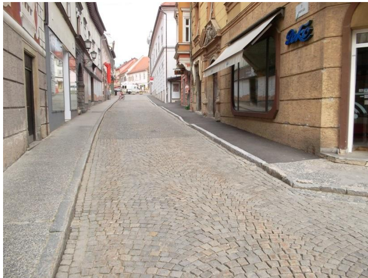
Slika 14: Neustrezni pločniki in asfaltne površine v Murkovi ulici
