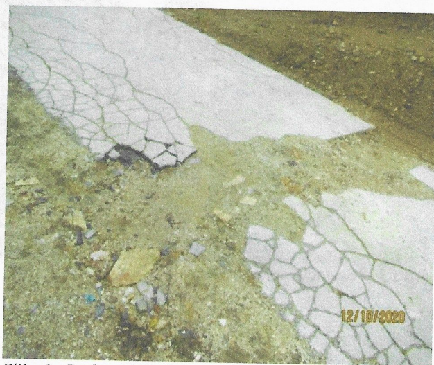
Slika 1: Prekop občinske ceste brez soglasja.
