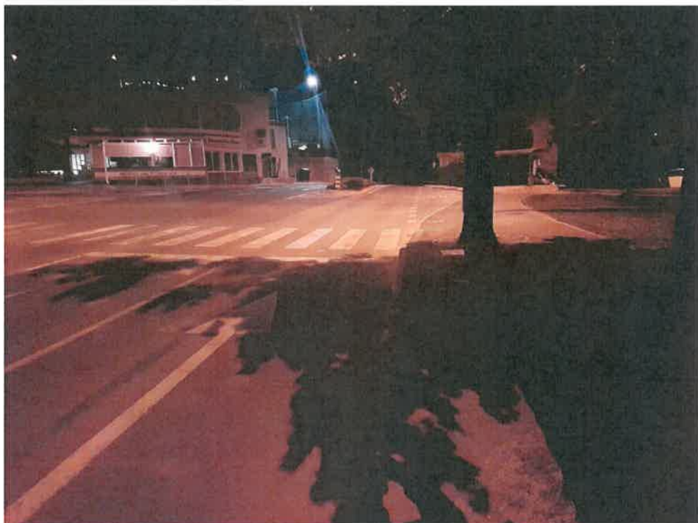
Pogled na prehod za pešce v nočnem času – drevesa zastirajo del območja pločnika pred prehodom za pešce, kar je nevarno (omejena zaznavnost pešca vozniku)
