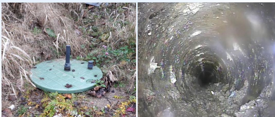
Slika 15: Cisterna za zbiranje izcedne vode iz deponije nenevarnih odpadkov Mala gora
