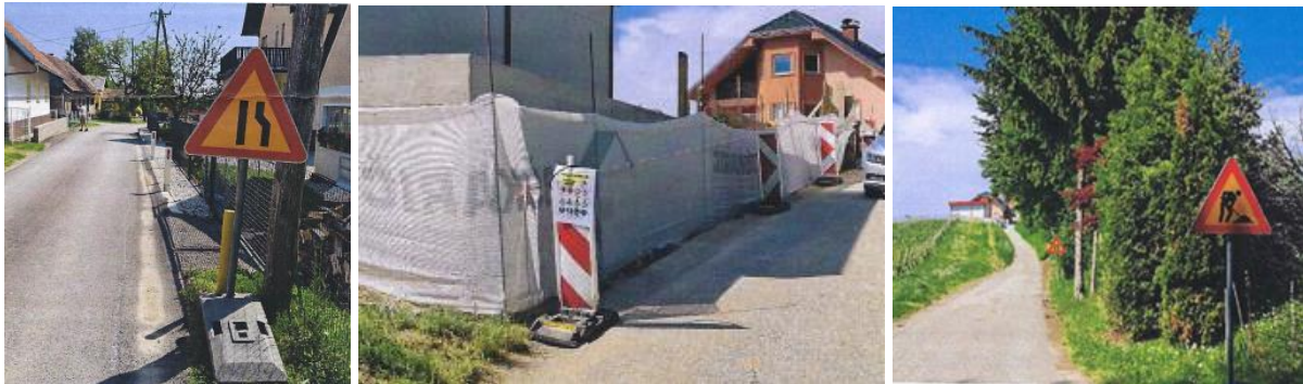
Stanje pred opravljenim izrednim inšpekcijskim pregledom občinske javne ceste JP 703-611 in po njem
