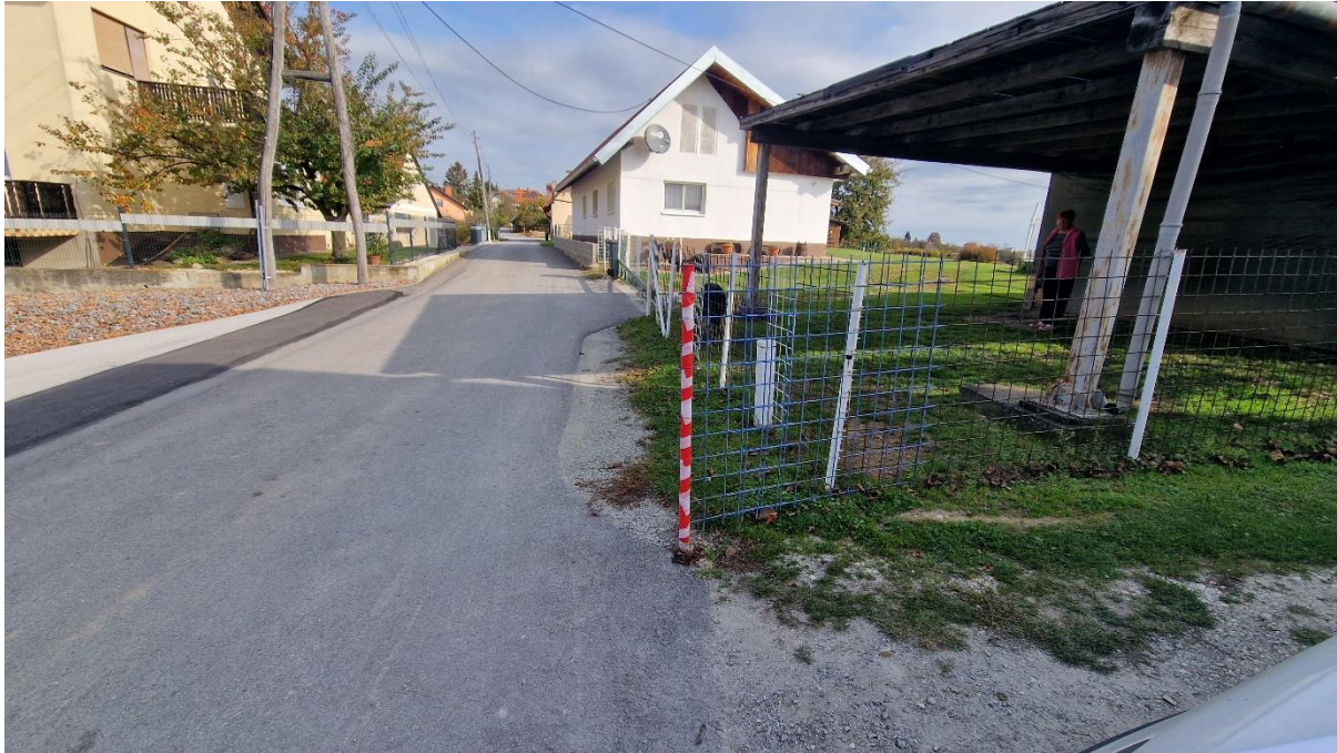
V varovalnem pasu postavljena kovinski steber višine 1,25 metra in betonska mreža modre barve enake višine brez soglasja
