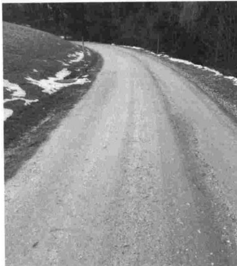
Slika 5: Pogled na konec meje obdelave na lokalni cesti LC 350371 (pri profilu P138)
