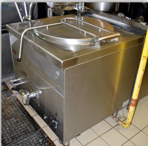
Kuhinjo na OŠ Zreče smo opremili z novim plinskim kotlom
